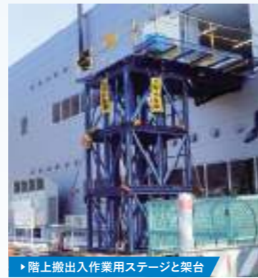
▶階上搬出入作業用ステージと架台
